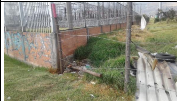
Imagen N°4. Daños al cerramiento.
